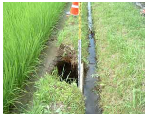
陥没の現場写真
